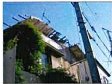
図 25：屋根が破損している例
