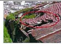
図 23：破損や変形が著しい例
