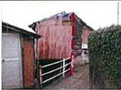
図 20：一部の柱が傾斜している例
