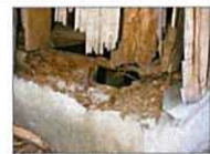
図 27：シロアリの害が発生した例
