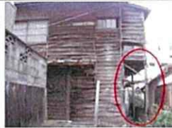
図 21：柱の数箇所に破損がある例
