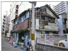
図 24：壁が剥落している例
