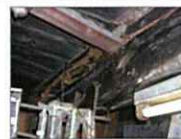
図 26：はりが破損、腐食している例
