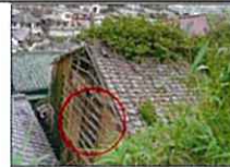
図 22：壁材が剥落している例
